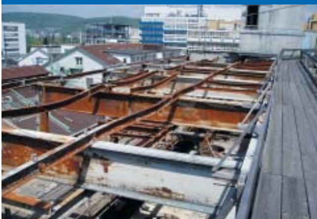
Bild oben: Demontage des obersten Stockwerks Bild unten: Grosse Hitzeschäden an der Stahlstruktur
